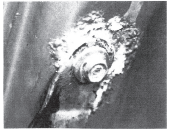
図2 ヒンジ部の締結部電位差腐食
