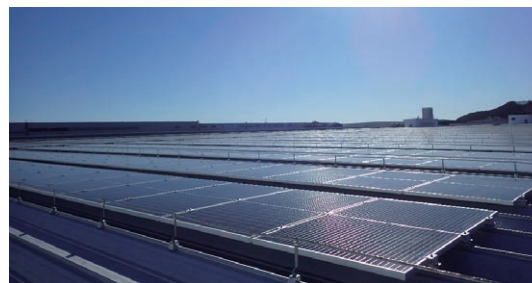
寄居工場 (2.0MW)
