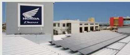
Honda DREAM松阪店の屋上には、(株)ホンダソルテック製の太陽電池モジュール計140枚が設置されています。発電出力は16キロワット。年間発電量は約17メガワット時を見込んでいます。
