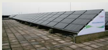
東風ホンダの屋上に設置された太陽電池
