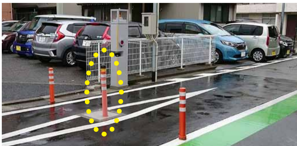
日和山小学校の周辺に設置されたライジングボラード（事前に設定した時間によって自動的に昇降する車止め）。許可車両や規制除外車はリモコン操作などによってボラードを降下させ、通行することができる。通行後、ボラードは自動的に上昇
