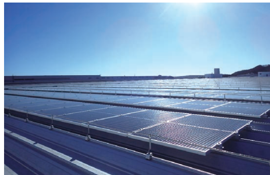
埼玉製作所 完成車工場 (2.0MW)
