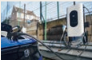
ロンドンのタウンホールに双方向充電器を設置
