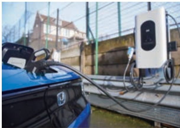
イギリス ロンドンに設置された双方向充電器
