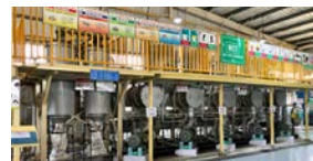
タップカラ工場(インド)の 排水リサイクルシステム
