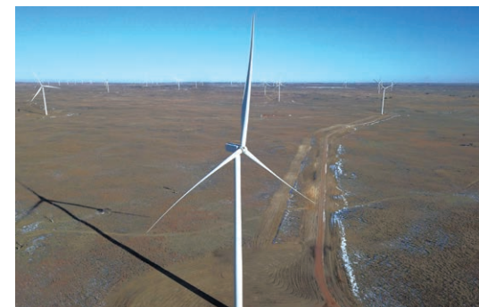
ポイリング・スプリングス風力発電所 (120MW)
