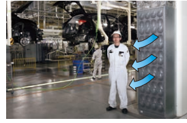
工場内の柱の低層部分に設置された空調吹き出し口
