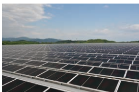
2.6MWの発電能力を有するソーラーパネル
