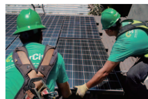
お客様のご家庭に太陽光発電システムを設置している様子
