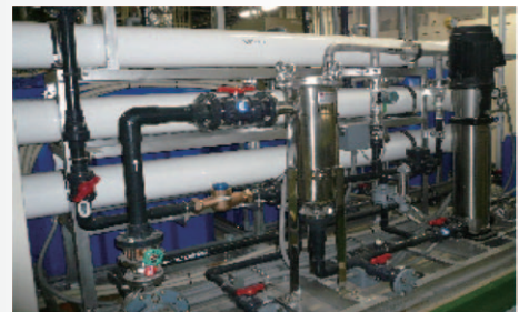
RO膜による高度処理装置
