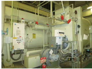
熱源設備更新
