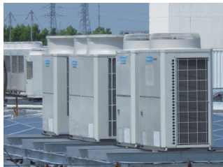
空調機高効率化
