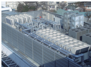
熱源更新(モジュールチラー15台)
