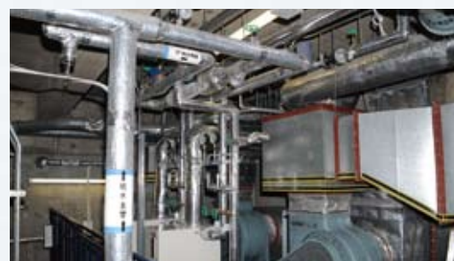
地下1階のロードヒーティング(融雪)機
