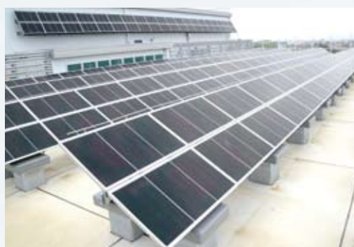
浜松製作所に設置された薄膜太陽電池
