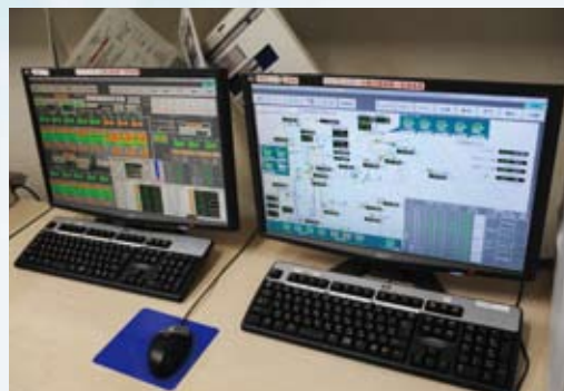
動力設備中央監視室にある制御システム
