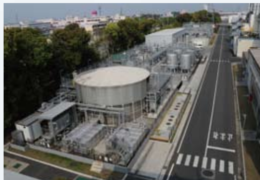
1列に配置された廃水処理施設。地下作業もなくなった
