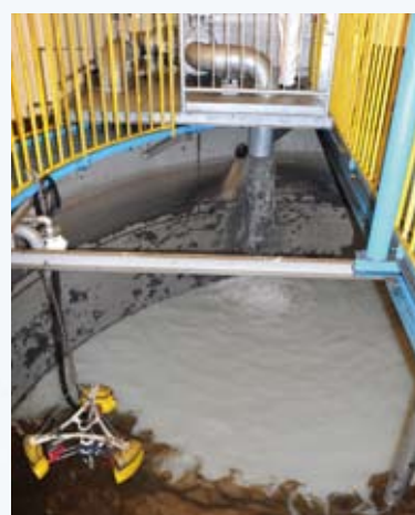
地上にある含油円形分離槽の中
