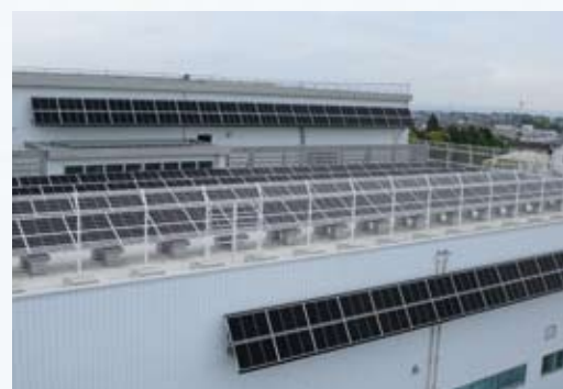
新工場の屋上と壁面に設置された太陽光発電システム
