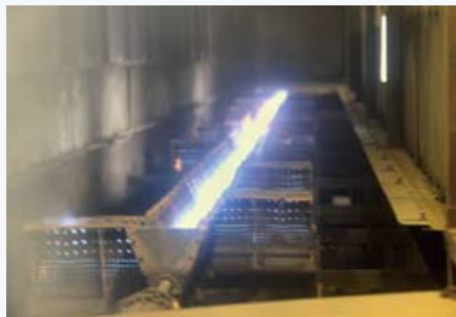
空調室ではLNGでバーナーを燃やしている
