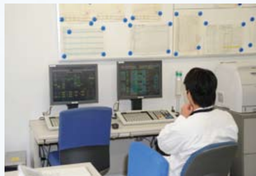
オペレーションルーム内の中央監視装置
