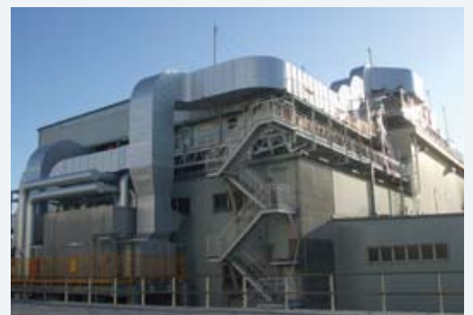
埼玉製作所のVOC処理装置
