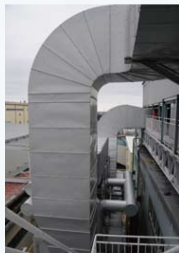
浄化された空気が流れるリサイクルダクト
