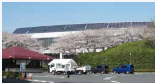
太陽光発電設備
