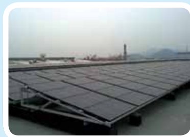
東風本田発動機有限公司が設置した ホンダソルテックの薄膜太陽電池
