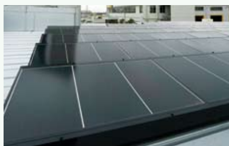
屋根の上に並ぶ140枚の太陽電池モジュール
