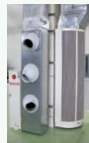
鋳造区の気流タワー、 吹出口は方向変更可能
