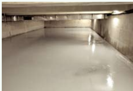
氷冷房 氷貯蔵槽
