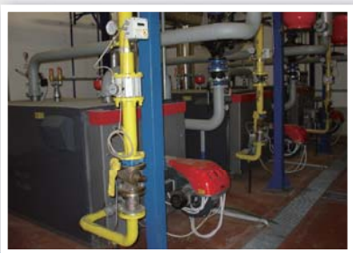
高効率の給湯ボイラーを導入
