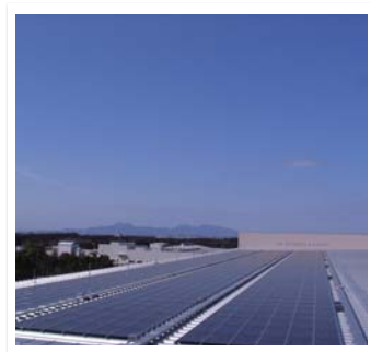
熊本製作所への設置例
