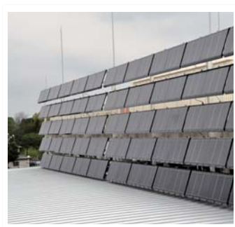
太陽光パネル
