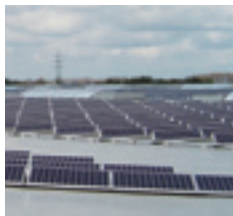
新倉庫のソーラーパネル
