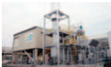
天然ガスコージェネレーションシステム (熊本製作所)
