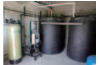
排水リサイクル設備
