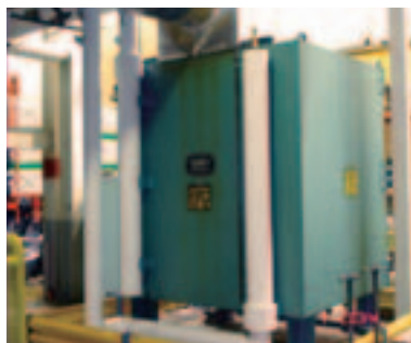
集中ボイラーから代替導入した熱回収・再利用装置
