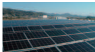
次世代型薄膜太陽電池(浜松製作所細江工場)
