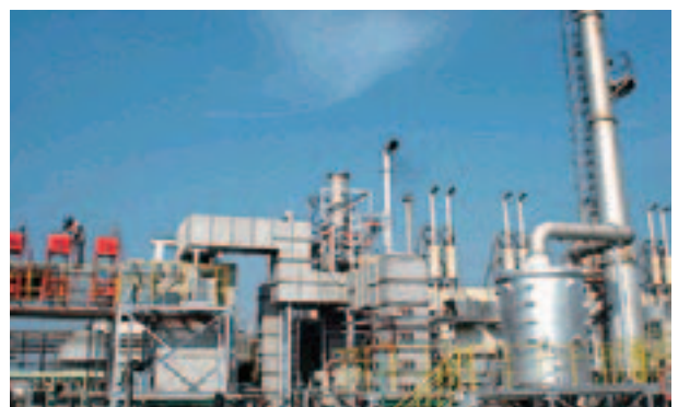
稼働を開始した新型焼却炉
