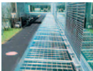
ホンダエンジニアリング製の太陽光発電パネルが設置された屋根
