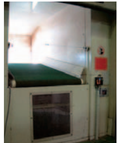
段ボールの減容設備
