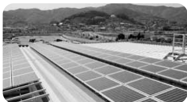
工場棟の屋根に設置された太陽電池パネル
