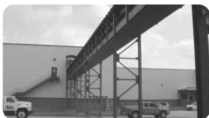
オイル類配管への漏洩対策 トラブルを迅速に発見できる架空配管、万一の備えに配管下部にはオイル受けを敷設。
