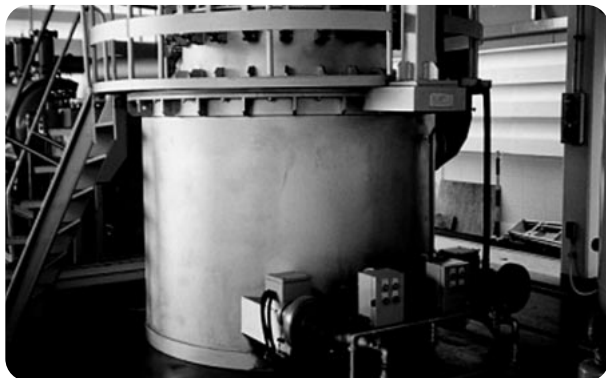
廃棄物乾留装置
