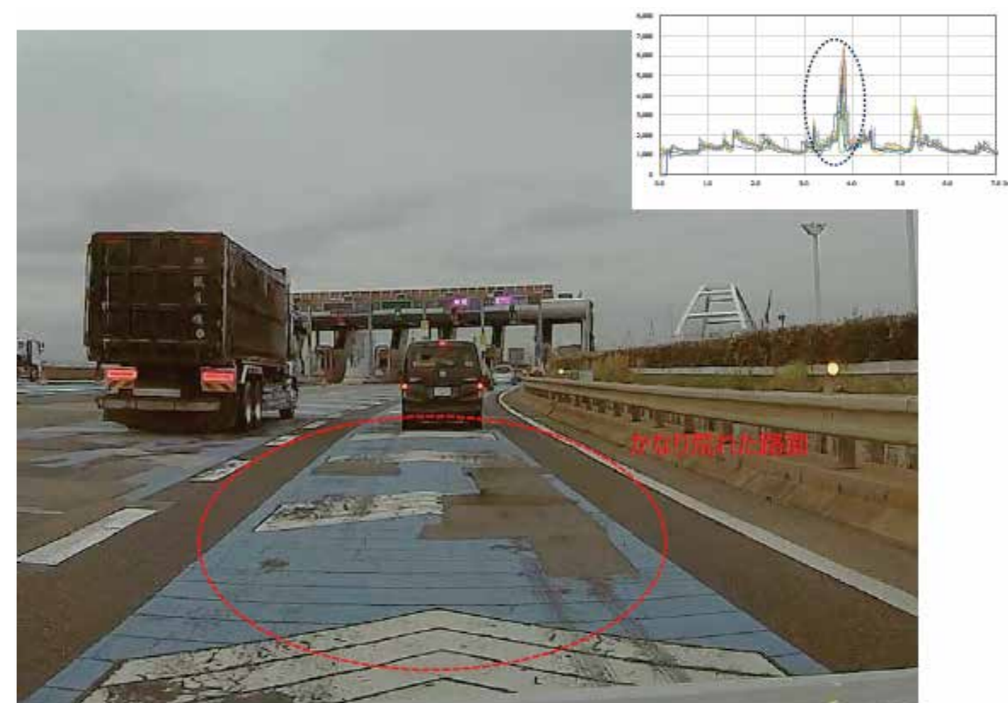
凸凹の大きな箇所における道路状況
